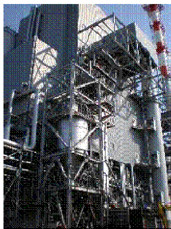
図-11 高岡工場(二塚)のボイラー
