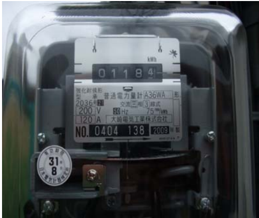
写真 1 高圧用電力量計
