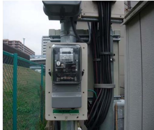
写真 2 高圧用電力量計全体図
