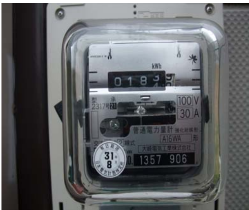
写真 3 低圧用電力量計
