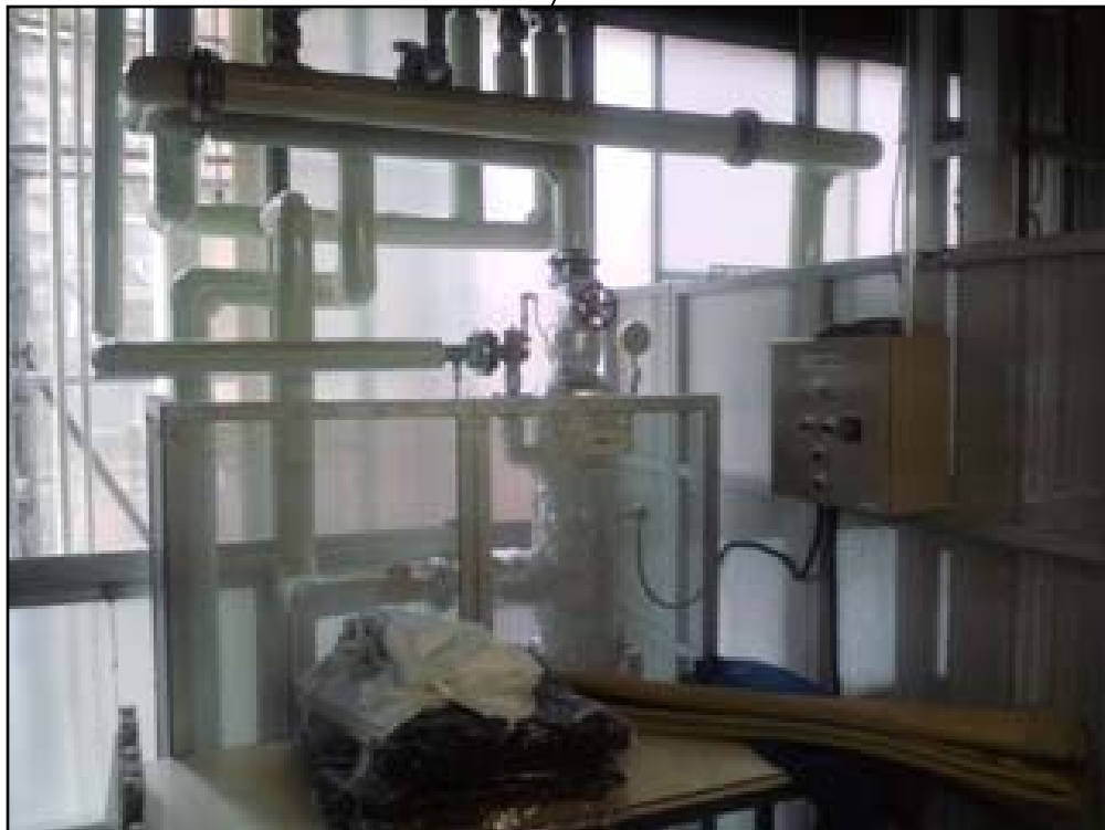
工場内に設置したフラッシュ蒸気発生装置
