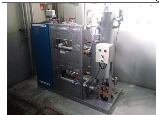
設置した再生蒸気回収装置
