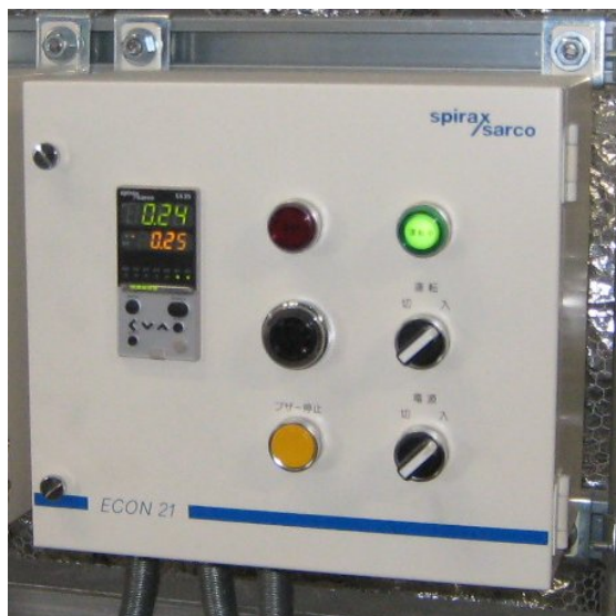
フラッシュ蒸気発生部圧力計
