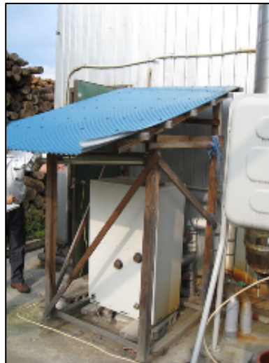
写真 2 代替された灯油ボイラー
