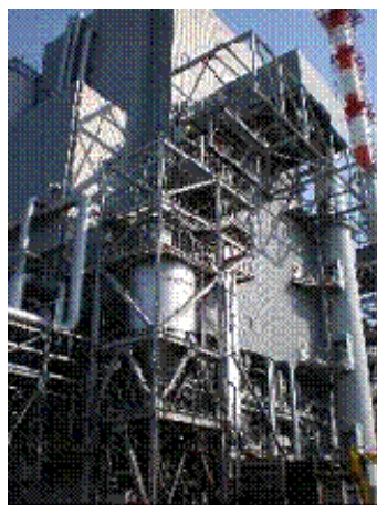
図-11 本事業に使用する高岡工場(二塚)のボイラー
